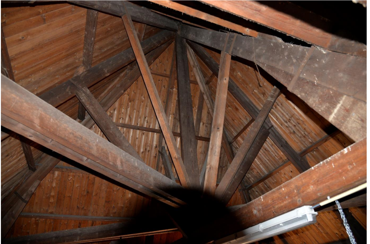
Foto 11 Niet geïsoleerd dak
